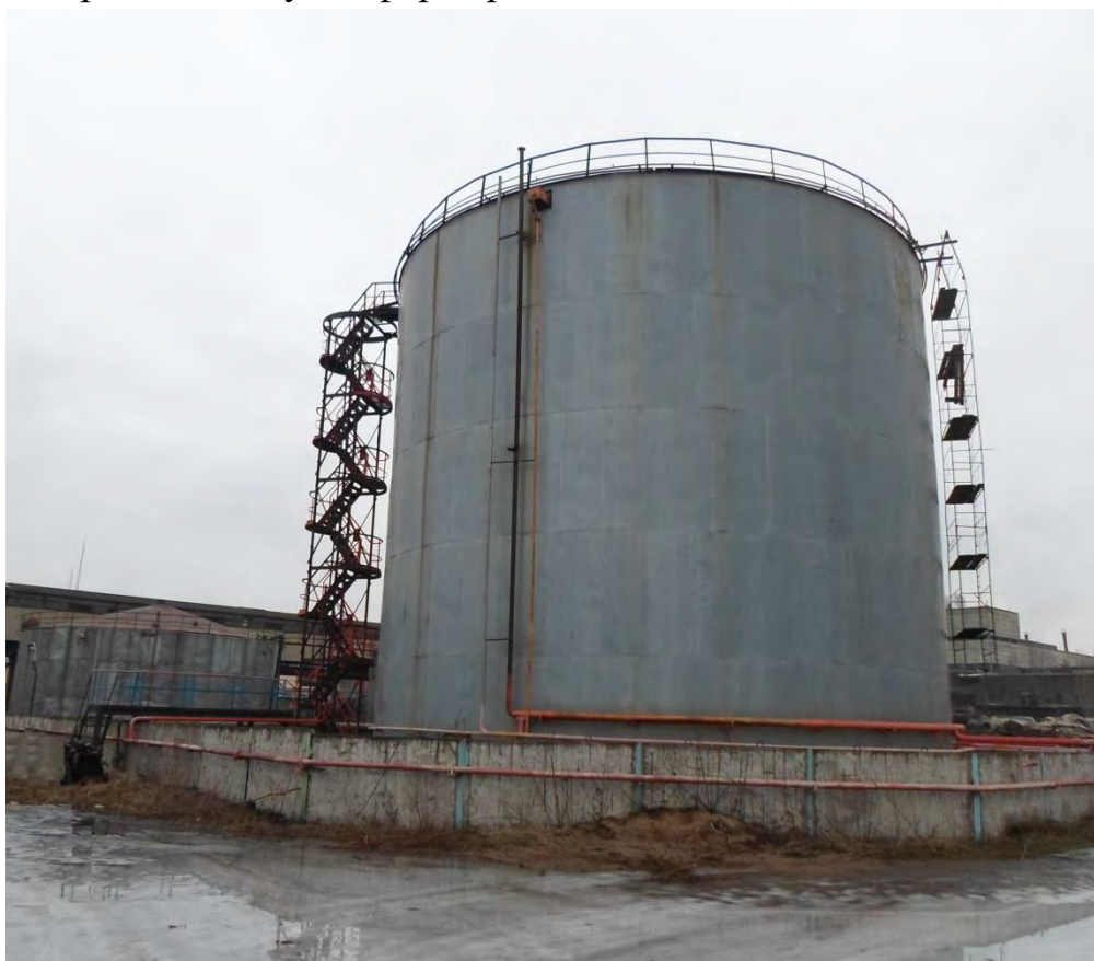
Рис. 2. Мазутохранилище в г. Санкт-Петербург, станция метро Кировский завод
